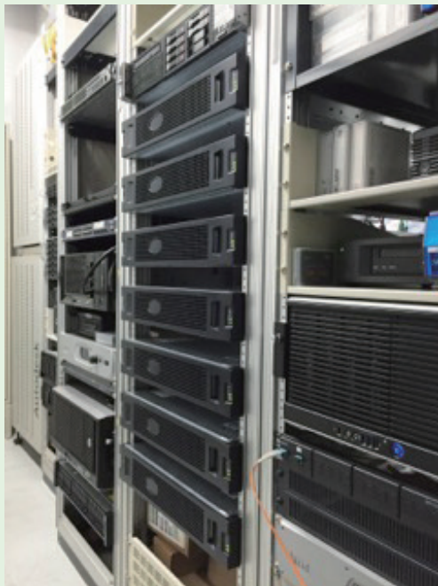
マシンルーム WIRED SERVER
